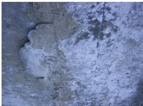
Рис. 1. Пример выщелачивания бетона
