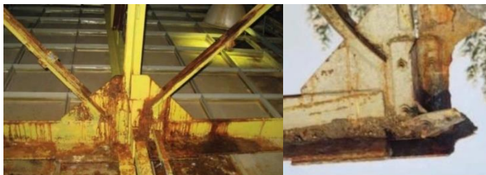
Рис. 4. Поврежденная ферма до обрушения и после
